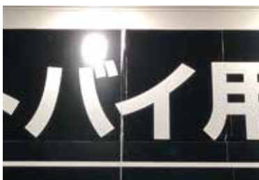
経年劣化の影響で縦に裂けめが入った屋外サイン
